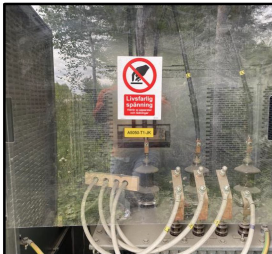
(Transformatorutrymme med plexiglas)
