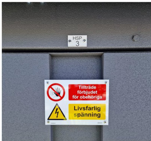
(Norrmontage AB, fackmärkning yttre fackdörr)
