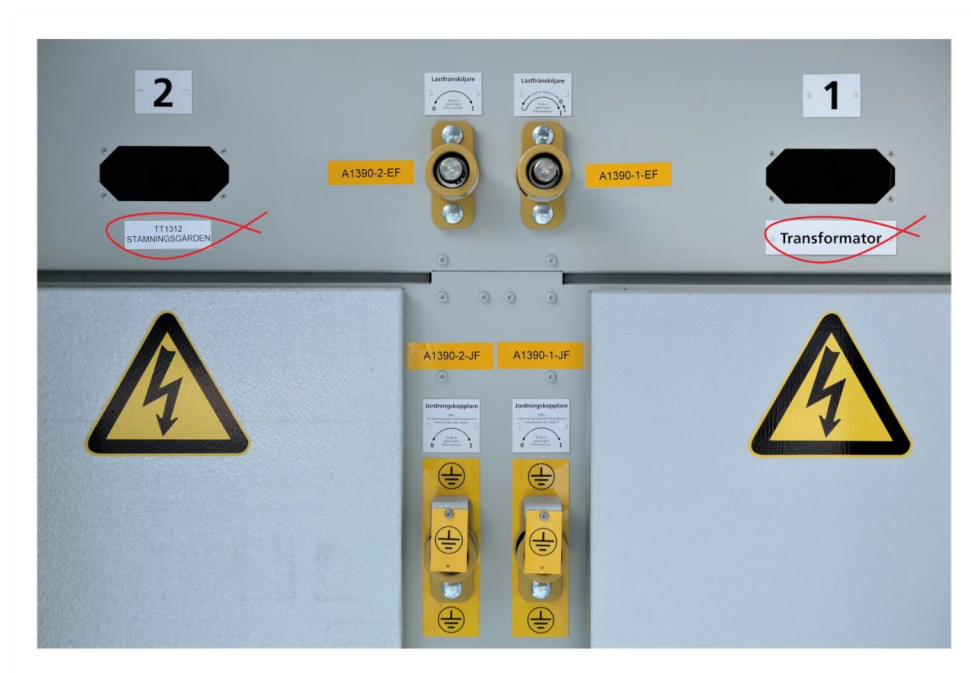
(Holtab, adressmärkning i högspänningsfack)
