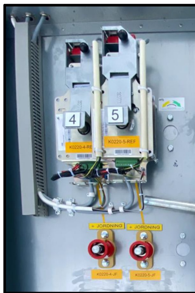
(Norrmontage AB, manöverfack/motordon)
