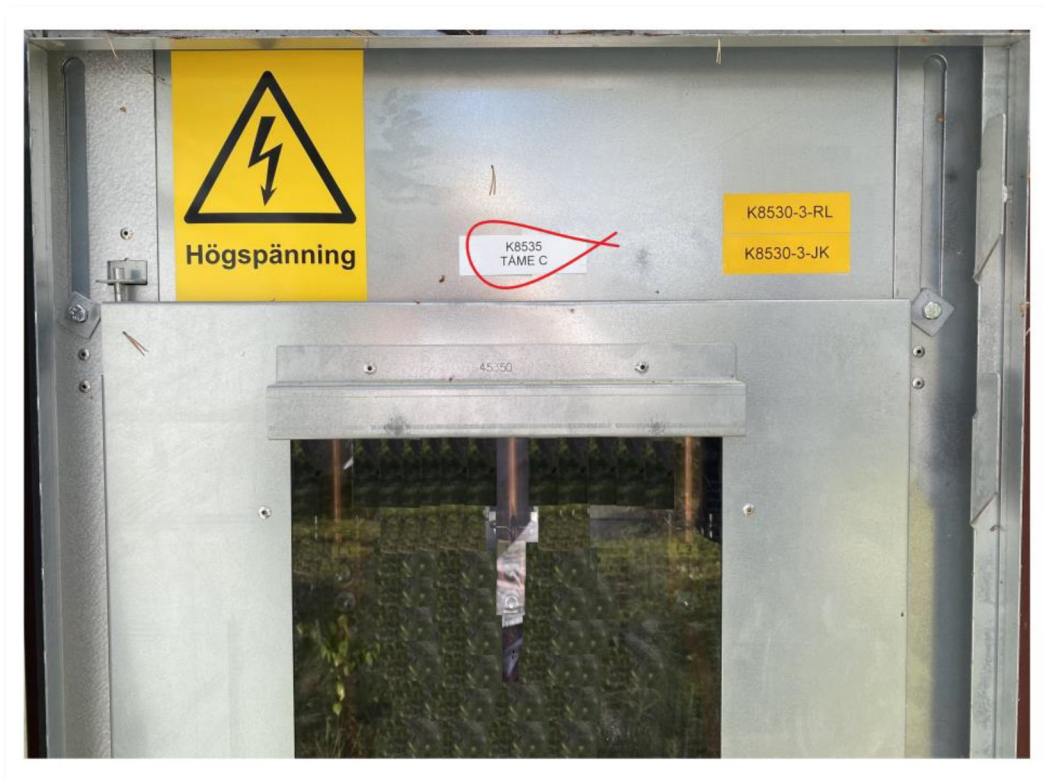
(Normontage AB, adressmärkning på fast del i högspänningsfack med dörr)
