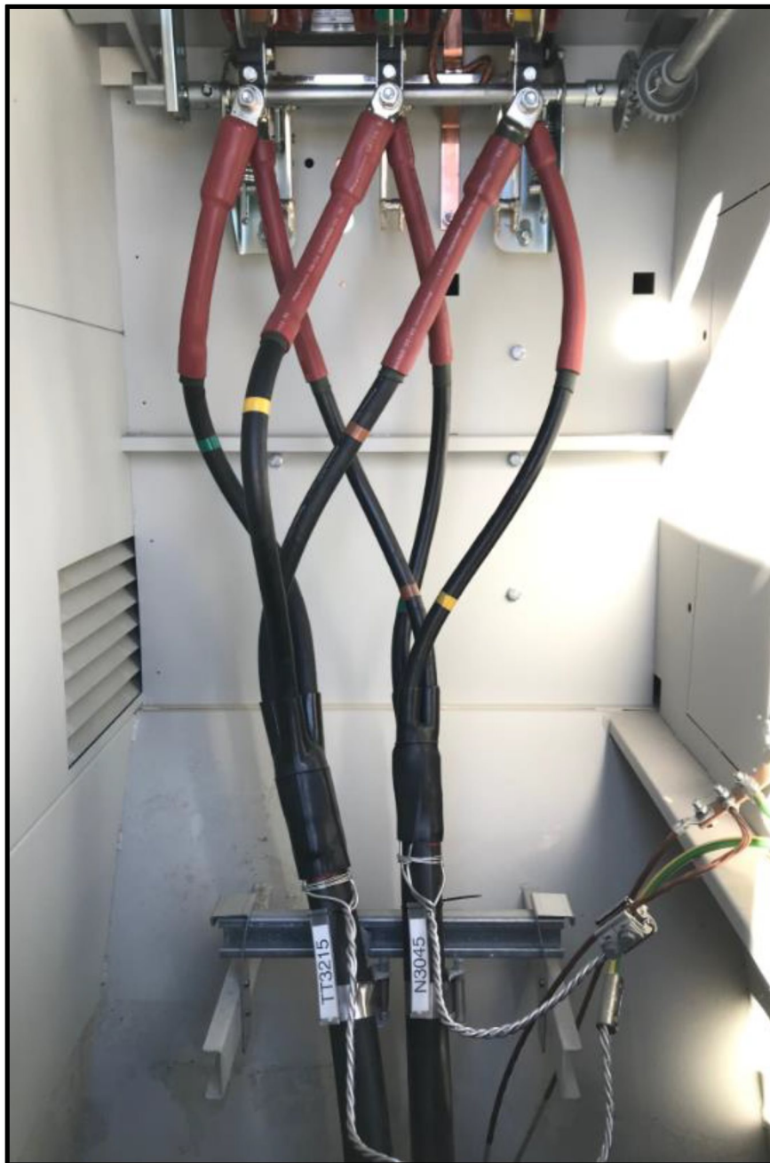
(Holtab, högspänningsfack med flera kablar)
