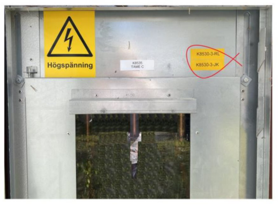
(Norrmontage, ID-märkning HSP-fack med dörr)
