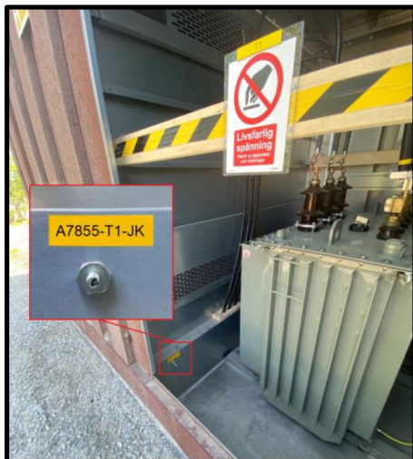
(Transformatorutrymme med träregel)
