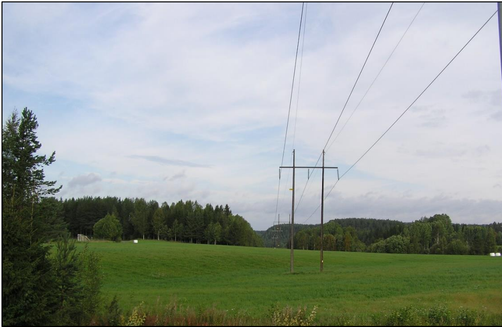
Figur 2. Foto med exempel på en ledning i portalstolpe i trä.
